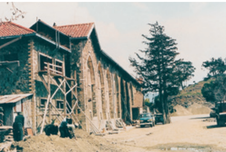
Η νότια είσοδος της Μονής. Παρουσιάζονται επισκευές της νότιας πτέρυγας της
